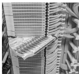
Зона монтажа и коммутации ОВ
